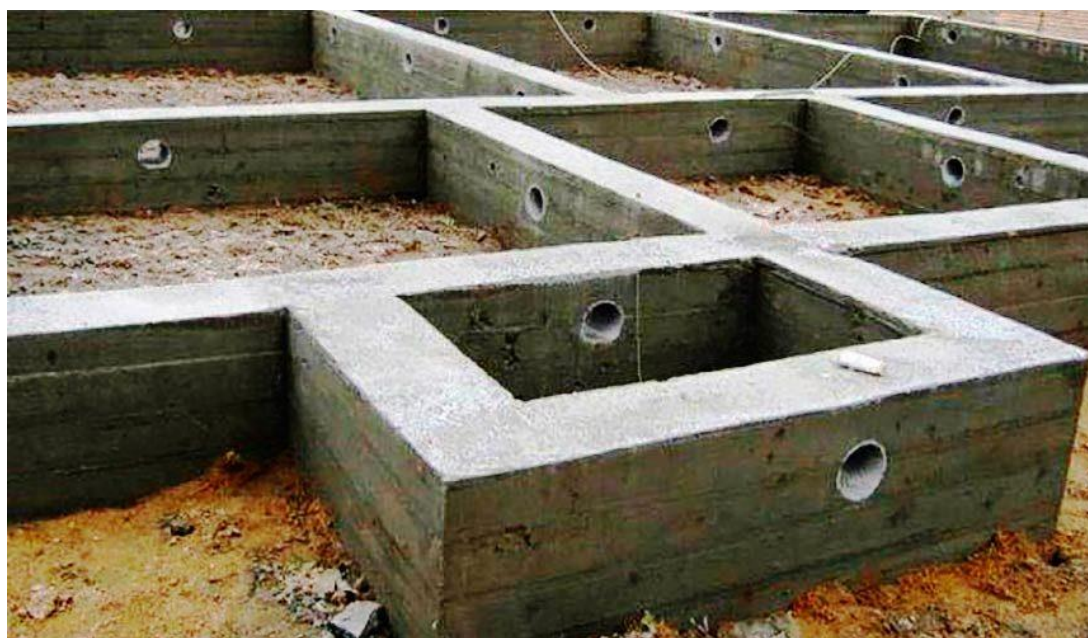
Рис. 22. Устройство вентиляционных отверстий в цоколе в случае наличия в здании техподполья или подвала
