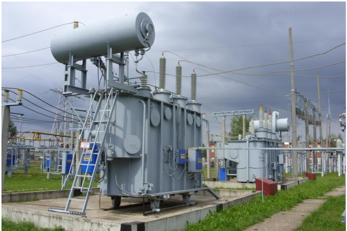
Трансформатор на линии 110 кВ.
