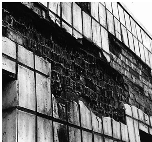
Рис. 1. Дефекты кирпичной стены промышленного здания, вызванные переувлажнением
