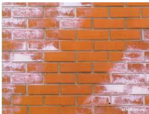
Рис. 4. Высолы на кирпичной стене
