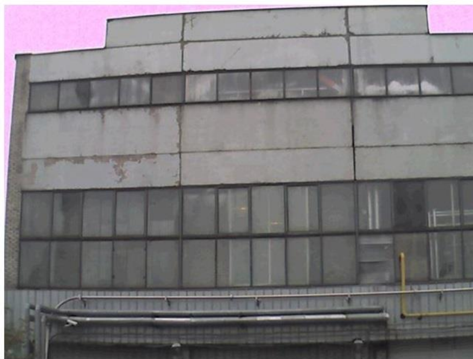
Рис. 2. Дефекты стены промышленного здания с навесными железобетонными панелями
